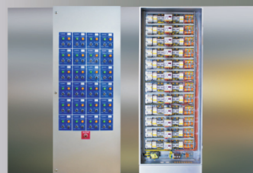
Шкаф управления задвижками 24
