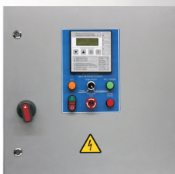
Шкаф управления насосной станцией
