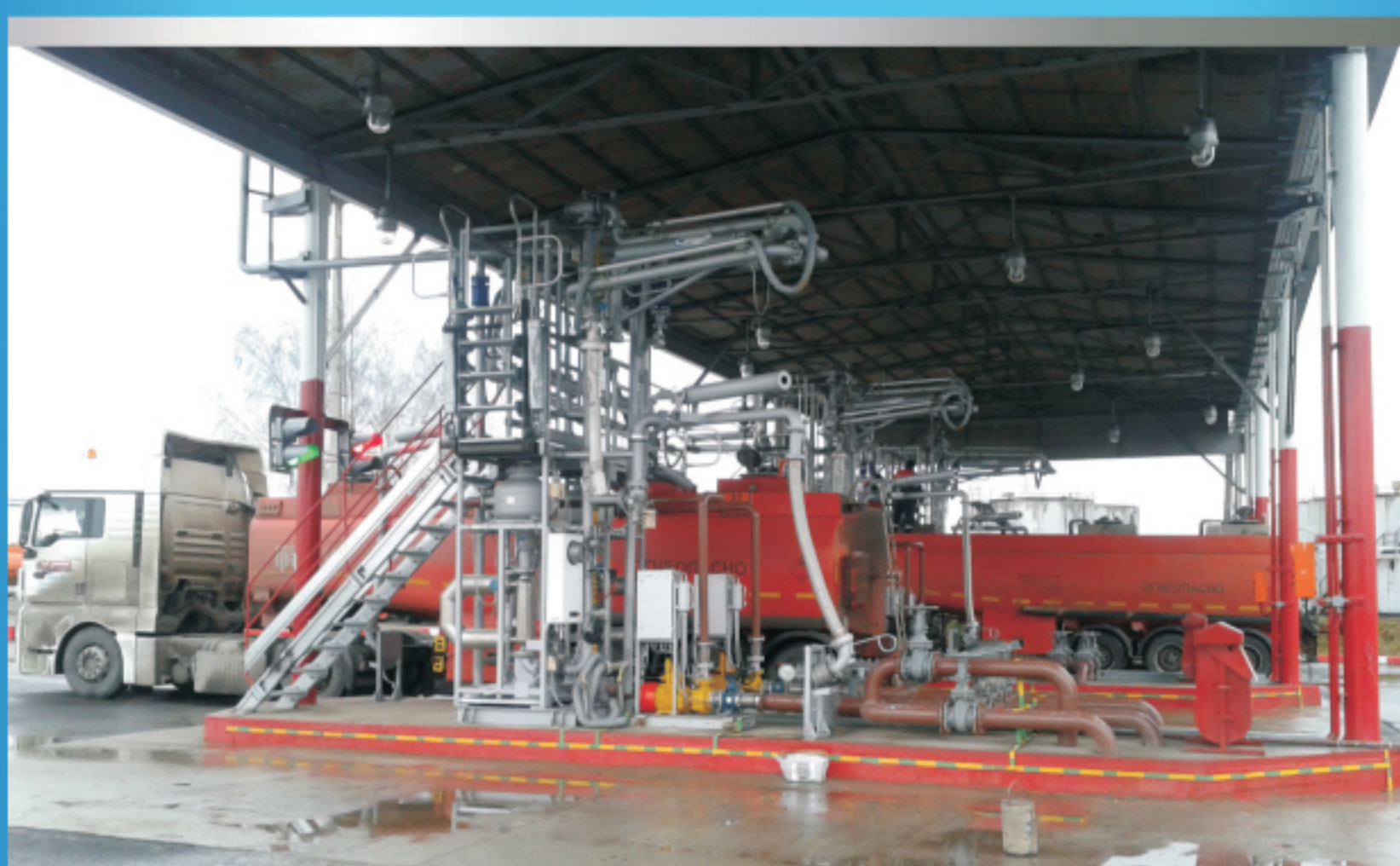
Станция "Каскад" на базе насоса KM в работе с измерительным комплексом АСН
